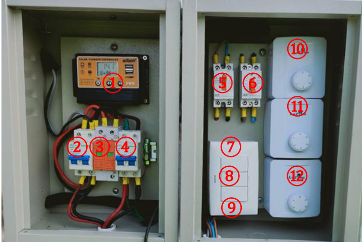
ภาพที่ 14 อุปกรณ์ไฟฟ้า ตู้ไฟฟ้าใต้แผงโซลาร์เซลล์
